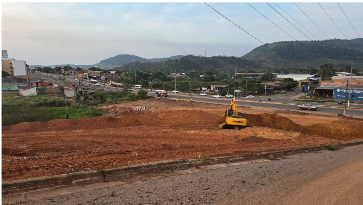
Imagem 6. Área terraplanada com marcas de esteira, montes de terra, entulho depositado e vegetação de baixada ao lado.
